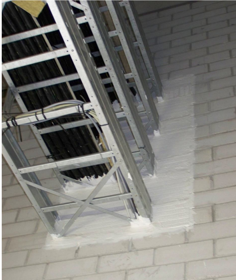
G4 sz. ábra. Villamos vezetékek tűzgátló lezárása szakszerűen kivitelezett lágyszárral (kétoldalt tűzvédelmi bevonattal ellátott kőzetgyapottal)
