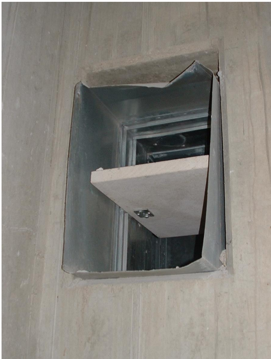
G3 sz. ábra. Tűzgátló csappantyú, amelynek sérülése a csappantyúnyelv beszorulását okozhatja; a csappantyúház és a fogadószerkezet közötti tűzgátló réskitöltő-réslezáró rendszer is hiányzik
