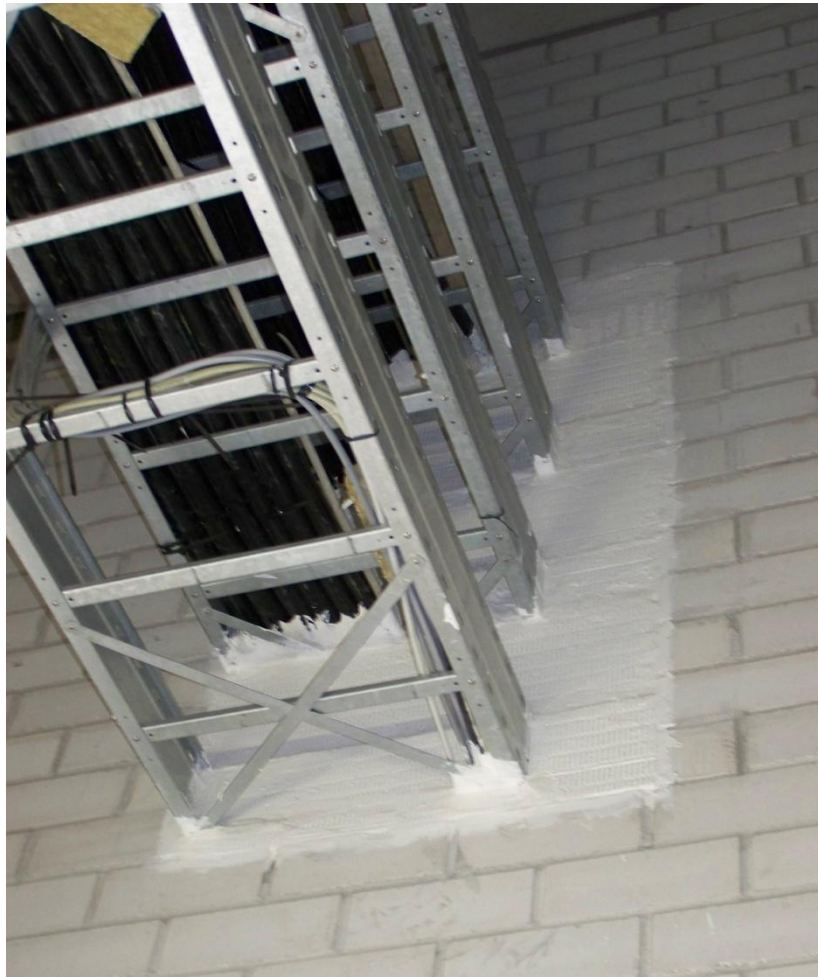
G4 sz. ábra. Villamos vezeték tűzgátló lezárása szakszerűen kivitelezett lágyszárral (kétoldalt tűzvédelmi bevonattal ellátott kőzetgyapottal)
