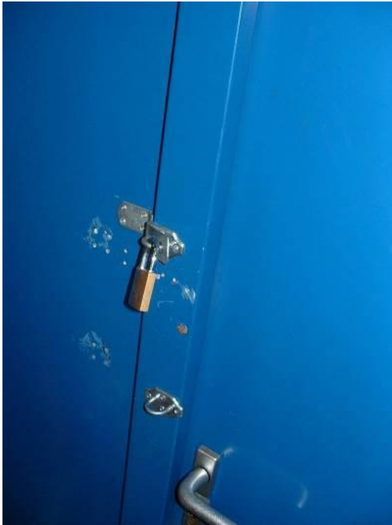
G2 sz. ábra. Nem megfelelően átalakított tűzgátló ajtó
