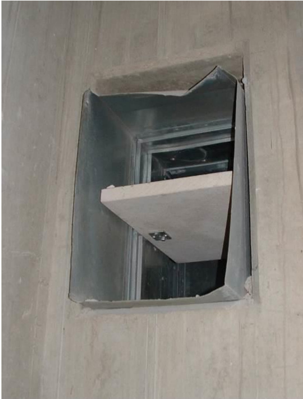
G3 sz. ábra. Tűzgátló csappantyú, amelynek sérülése a csappantyúnyelv beszorulását okozhatja; a csappantyúház és a fogadószerkezet közötti tűzgátló réskitöltő-réslezáró rendszer is hiányzik
