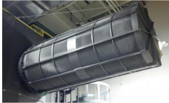
2. ábra – lángmentes lefűvató berendezéssel szerelt porleválasztó
